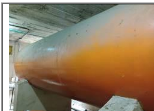
Tanque de Agua
