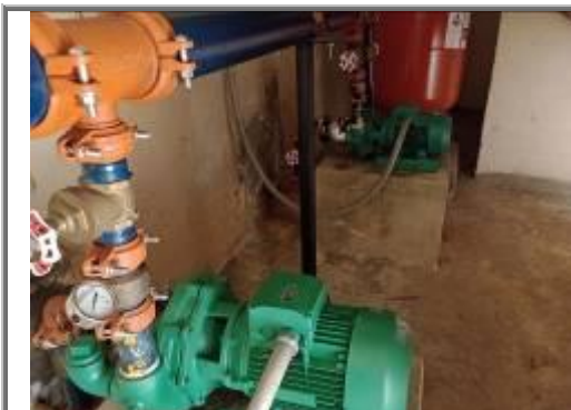
Bombas de Suministro
