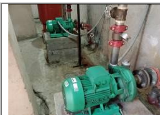
Bombas de Suministro
