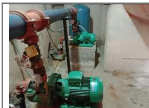
Bombas de Suministro
