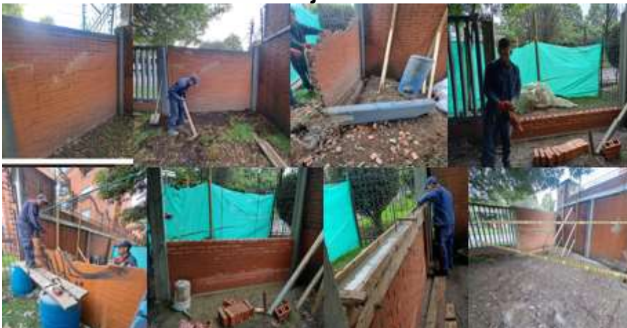
Imagen 34. Reconstrucción de área de muro de cerramiento sobre la calle 53 en área colindante con el conjunto Balcones de Paulo VI
