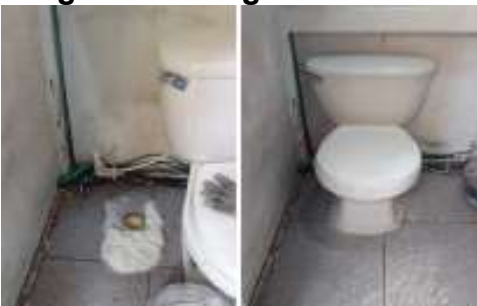
Imagen 15. Arreglo de sanitario en la caseta de vigilancia
